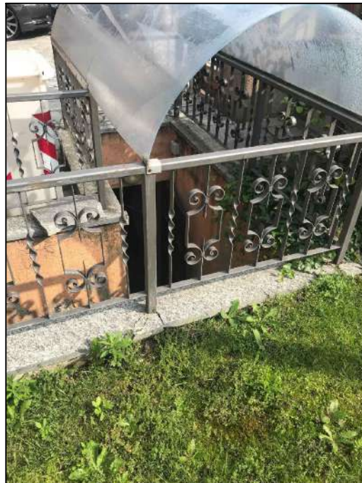
Foto 12 - SCALA ACCESSO A C.T. CORTE ESTERNA
