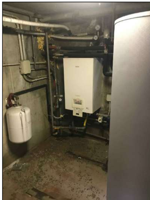
Foto 14 - CENTRALE TERMICA COMUNE
