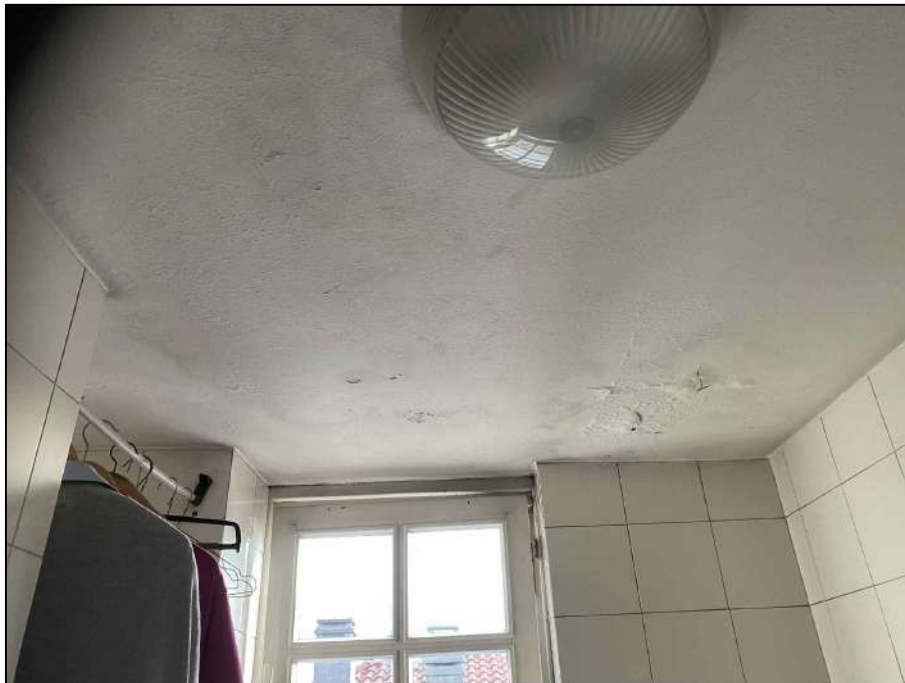
Foto 85 - BAGNO 2, DETTAGLIO SOFFITTO
