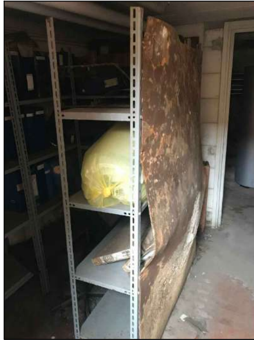
Foto 13 - LOCALE ANTICALDAIA COMUNE
