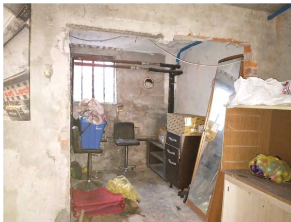
Locale caldaia P.S1
