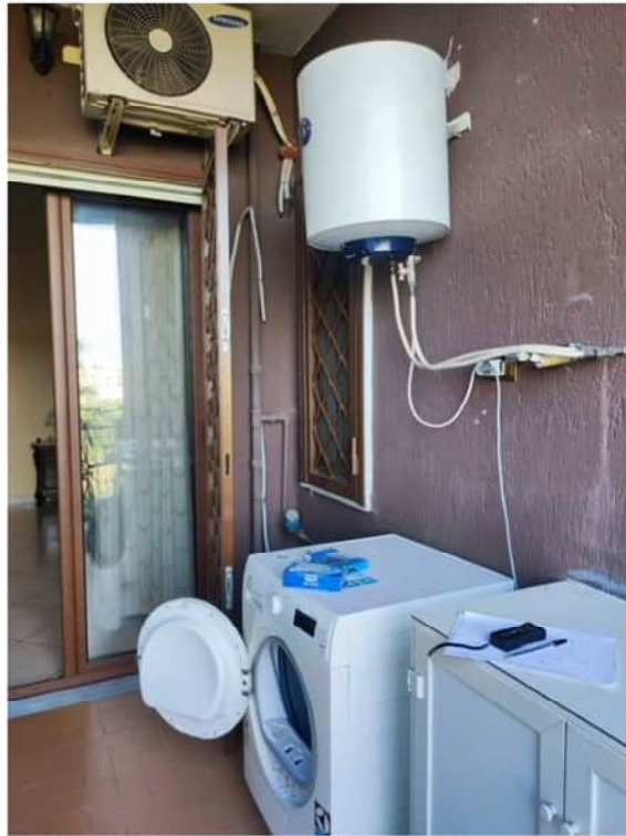
Foto14. Balcone esterno con boiler
