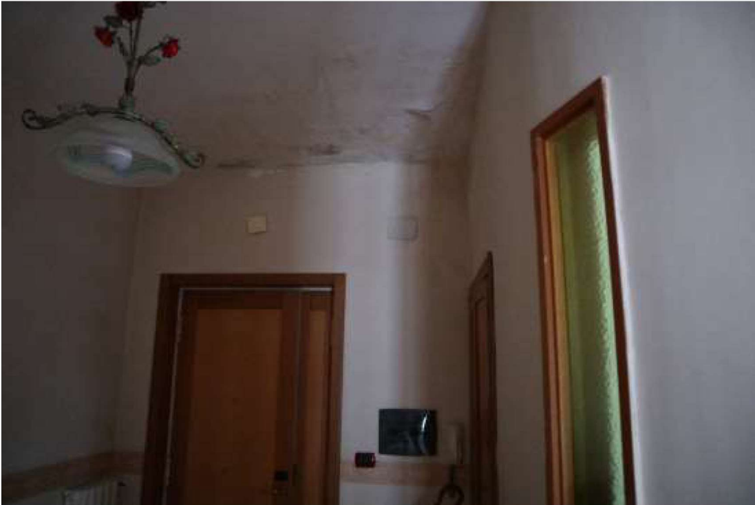
INGRESSO (CON TRACCE DI INFILTRAZIONI AL SOFFITTO)
