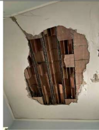
Sfondellamento solaio bagno piano terra
