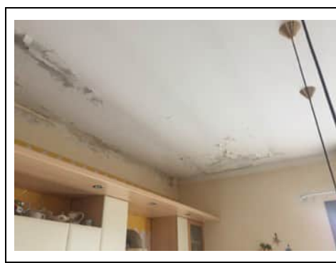
Immagine n.19 – danneggiamento cucina
