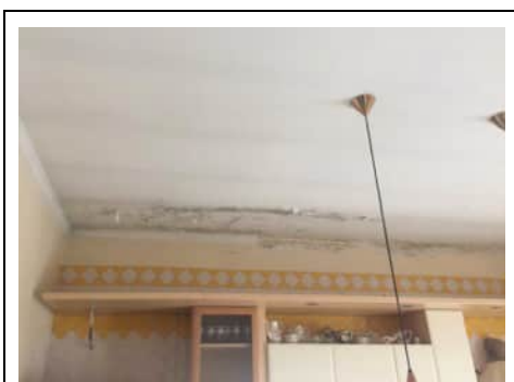
Immagine n.20 – danneggiamento cucina
