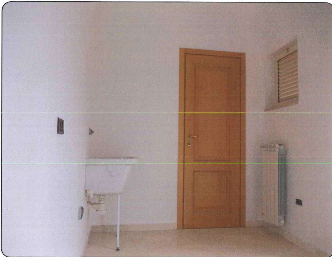
Foto 12: lavanderia e centrale termica
