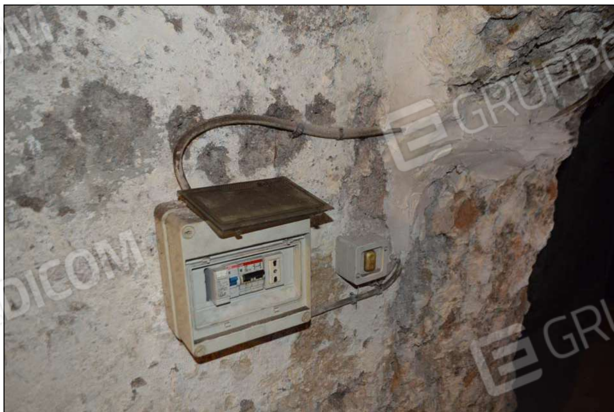
Foto n. 18 – Particolare quadro elettrico
