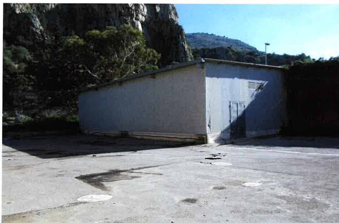
Foto 38: il manufatto, indicato catastalmente come officina, ad est del complesso, del quale ho previsto la rimozione, in quanto realizzato in assenza di atti autorizzativi ed incluso tra quelli oggetto delle istanze di concessione in sanatoria denegate
