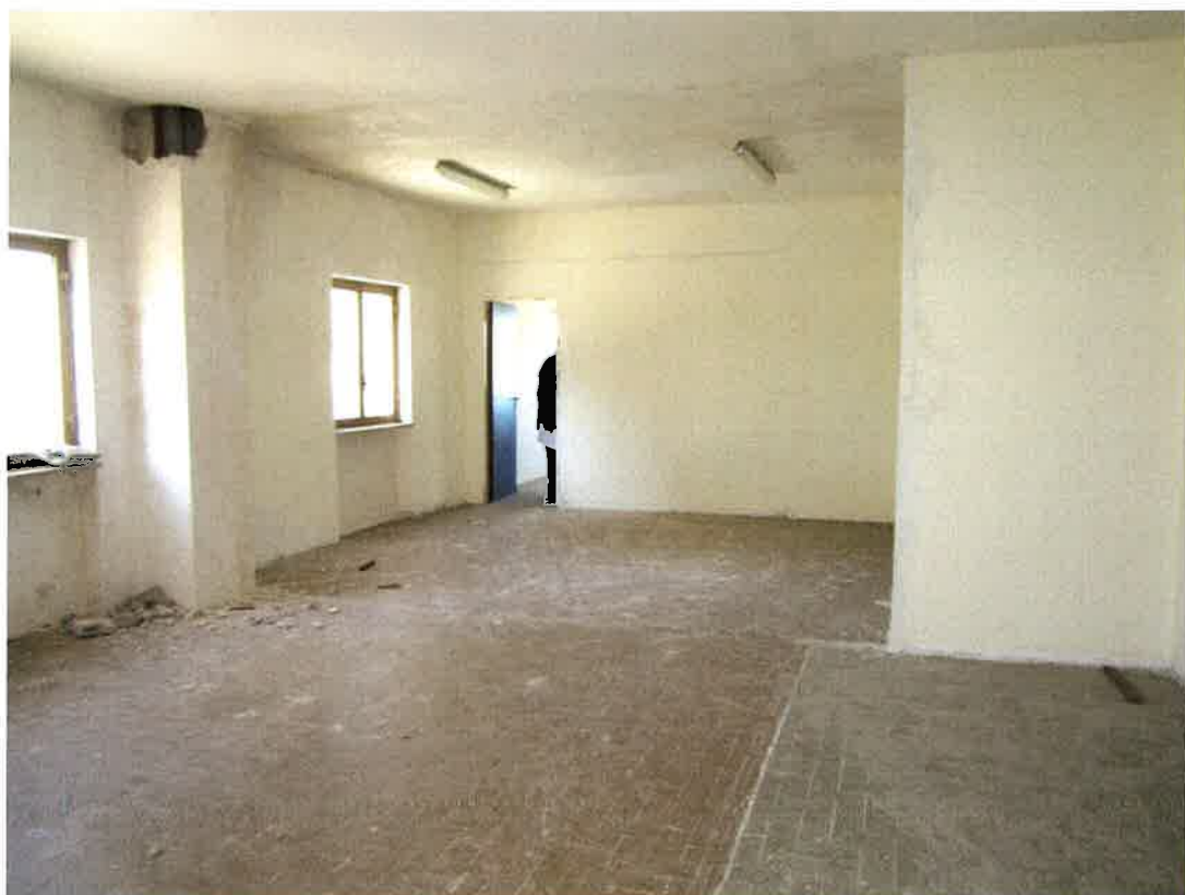
Foto 32: altri ambienti al primo piano del capannone ubicato ad ovest del complesso, già adibiti a spogliatoi e servizi, oggi dismessi e non utilizzati
