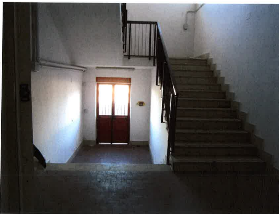
Foto 21: una delle due scale che conducono ai locali al primo piano del capannone ubicato ad ovest del complesso, già adibiti a spogliatoi e servizi, oggi dismessi
