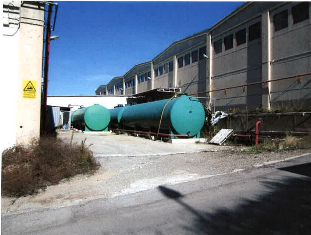
Foto 35: la riserva idrica dedicata, a servizio dell'impianto antincendio del complesso immobiliare a destinazione commerciale/logistica
