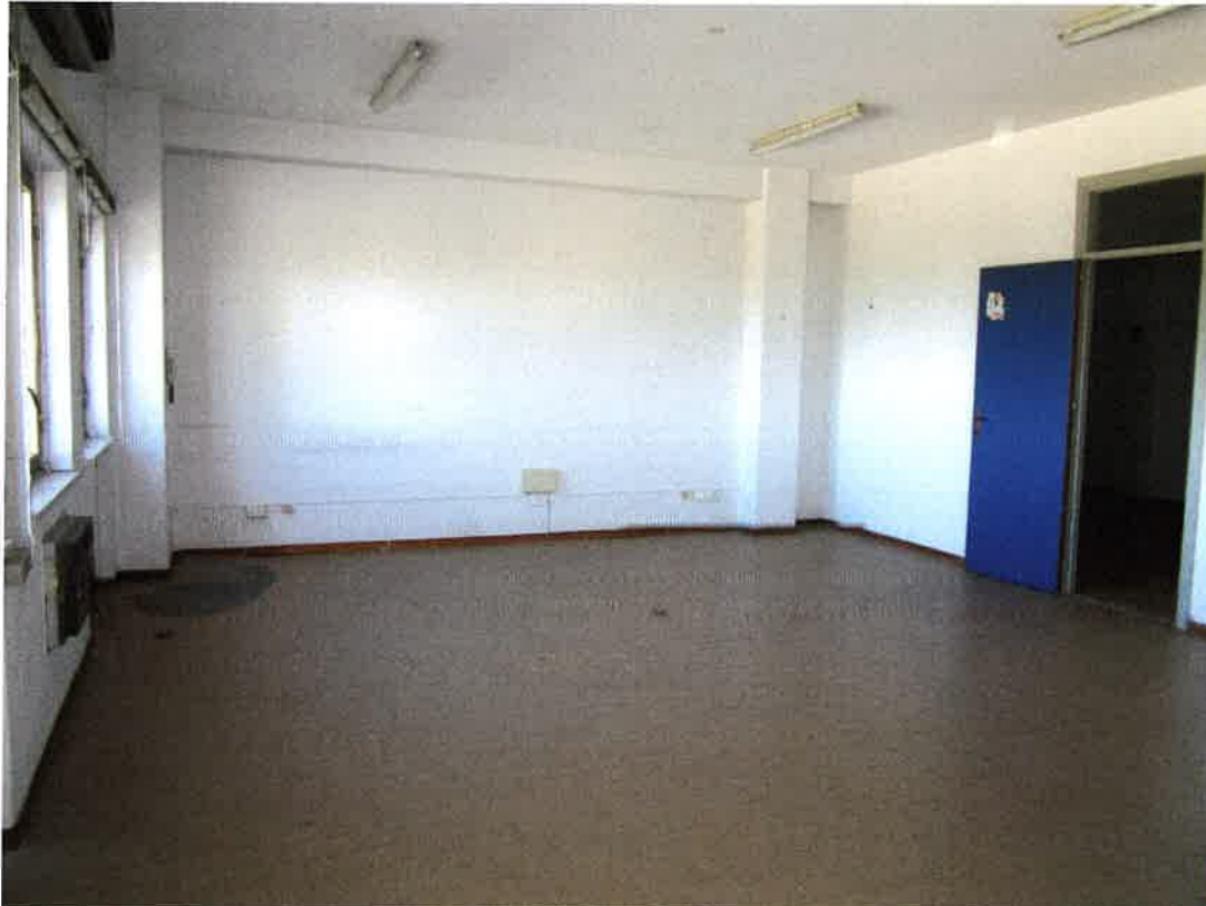
Foto 26: un altro degli ambienti al primo piano del capannone ubicato ad ovest del complesso, già adibiti a spogliatoi e servizi, oggi dismessi e non utilizzati
