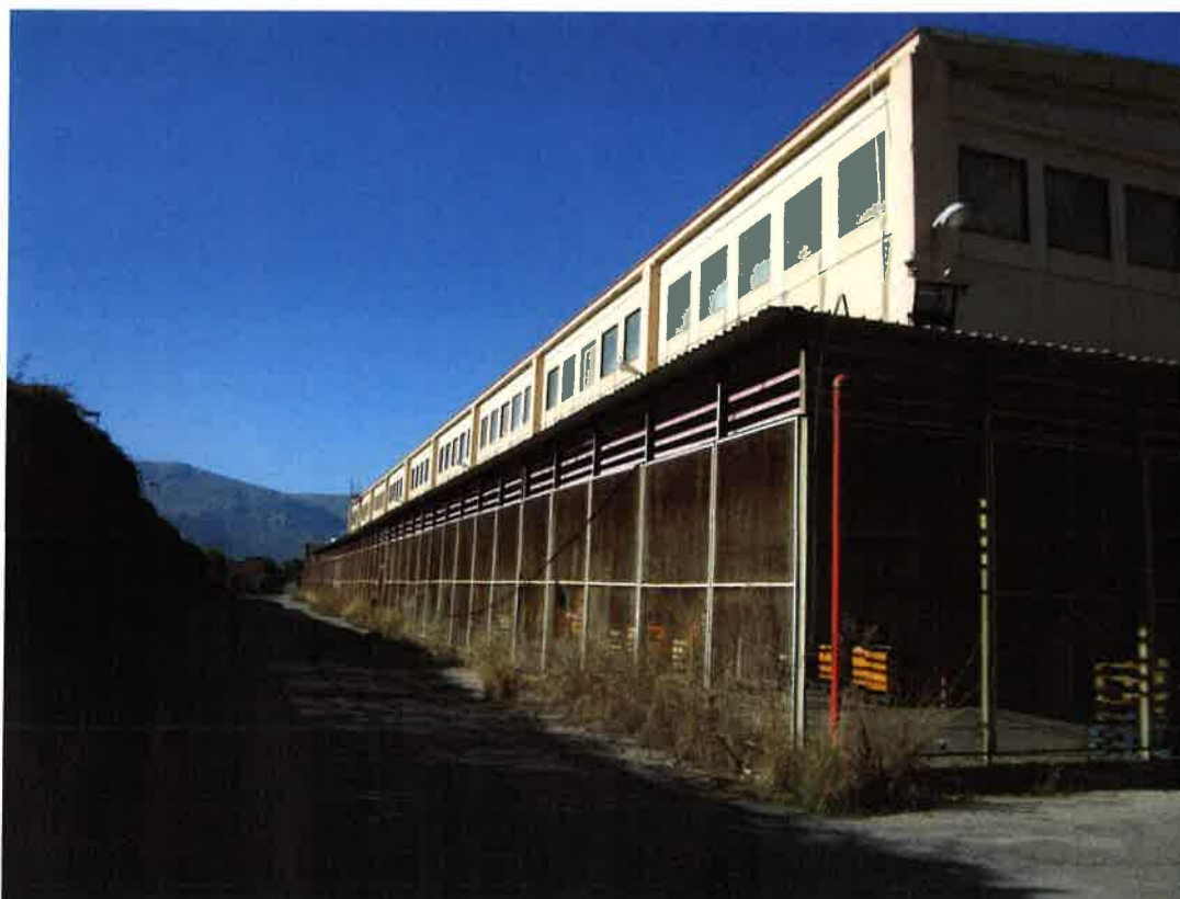
Foto 37: inquadratura, dal punto di vista opposto rispetto alla foto precedente, del prospetto sud del capannone ubicato ad est del complesso, lungo il quale si sviluppa la tettoia che ospita le alimentazioni per la ricarica dei carrelli; preciso che ho previsto la rimozione di tale tettoia, in quanto realizzata in assenza di atti autorizzativi ed inclusa tra i manufatti oggetto delle istanze di concessione in sanatoria denegate
