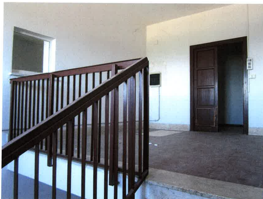
Foto 22: lo sbarco al primo piano della scala interna che conduce ai locali del capannone ubicato ad ovest del complesso, già adibiti a spogliatoi e servizi, oggi dismessi
