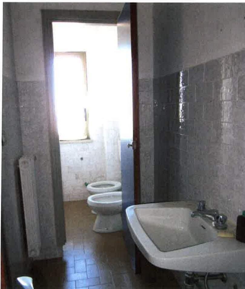
Foto 29: un altro dei servizi al primo piano del capannone ubicato ad ovest del complesso non utilizzato
