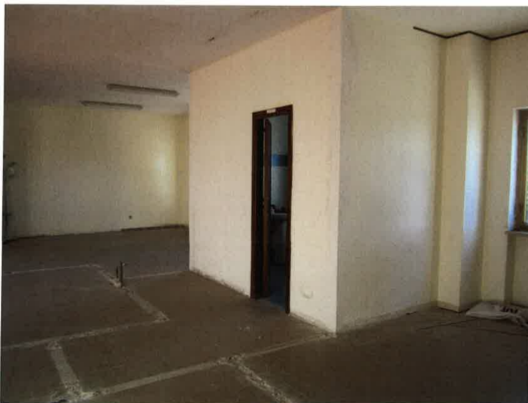
Foto 33: altri ambienti al primo piano del capannone ubicato ad ovest del complesso, già adibiti a spogliatoi e servizi, oggi dismessi e non utilizzati
