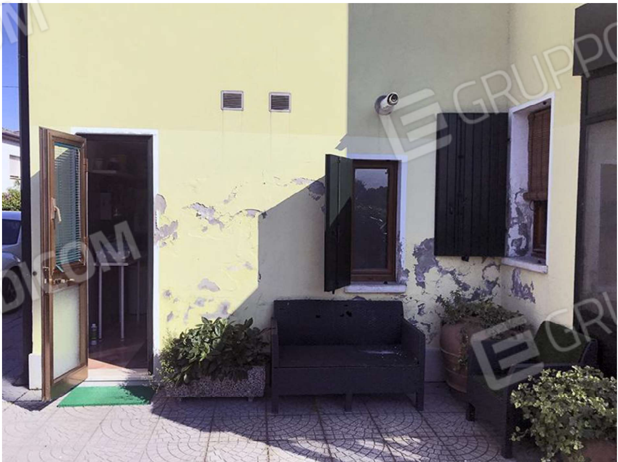
Il lato nord con la porta del cucinino e problemi di umidità.
