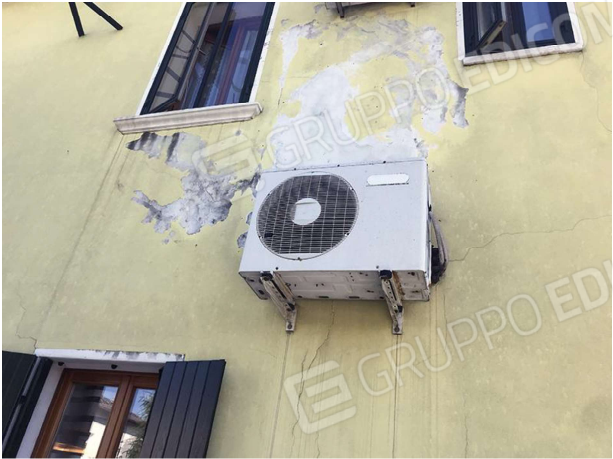
Problemi di umidità e fessurazioni sul lato est.
