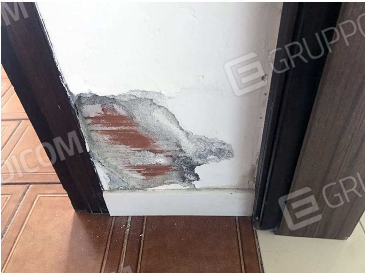
Problemi di umidità nel disimpegno all'uscita del bagno.
