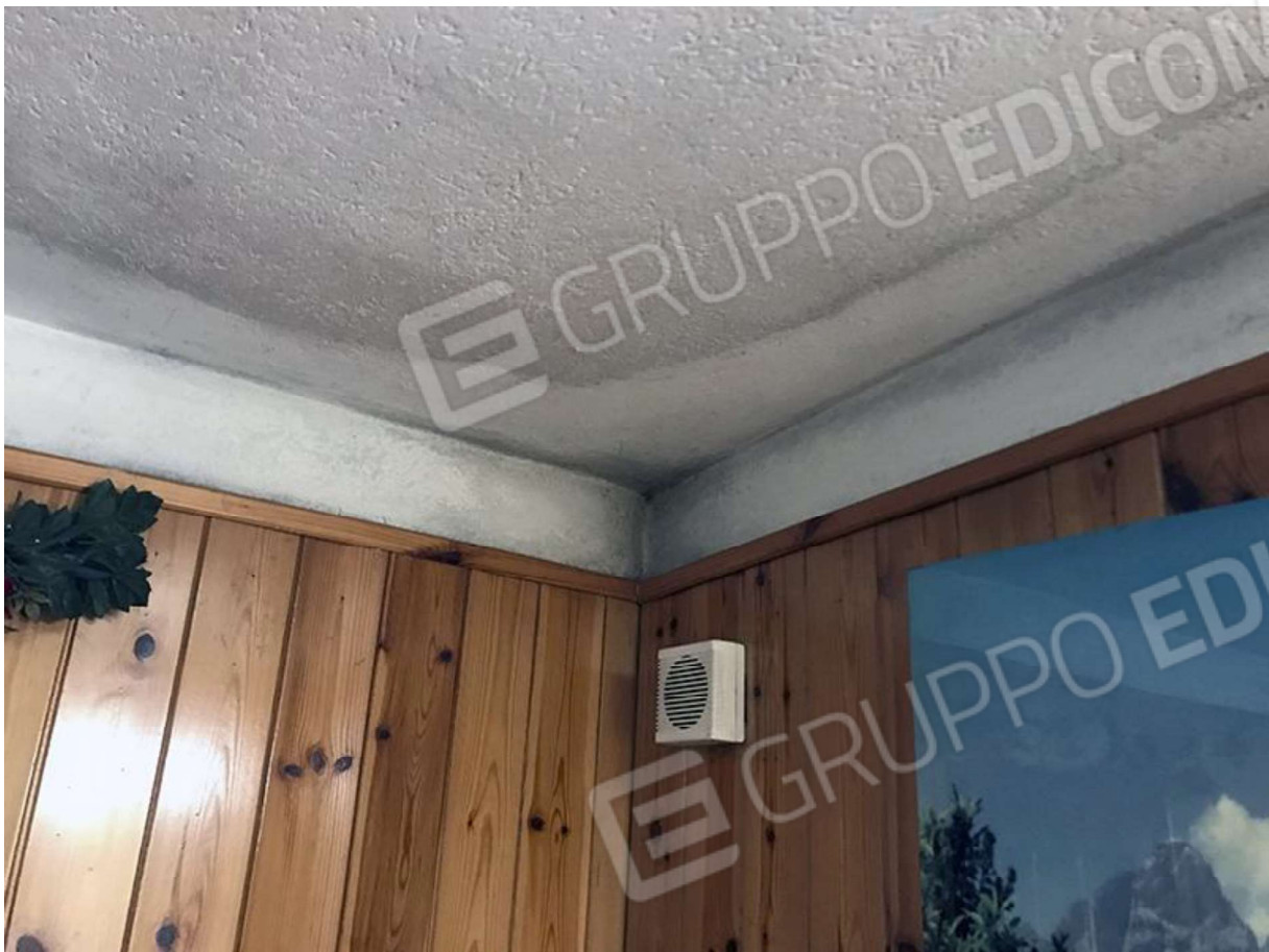
Problemi di umidità sul soffitto del locale garage (sub 3).
