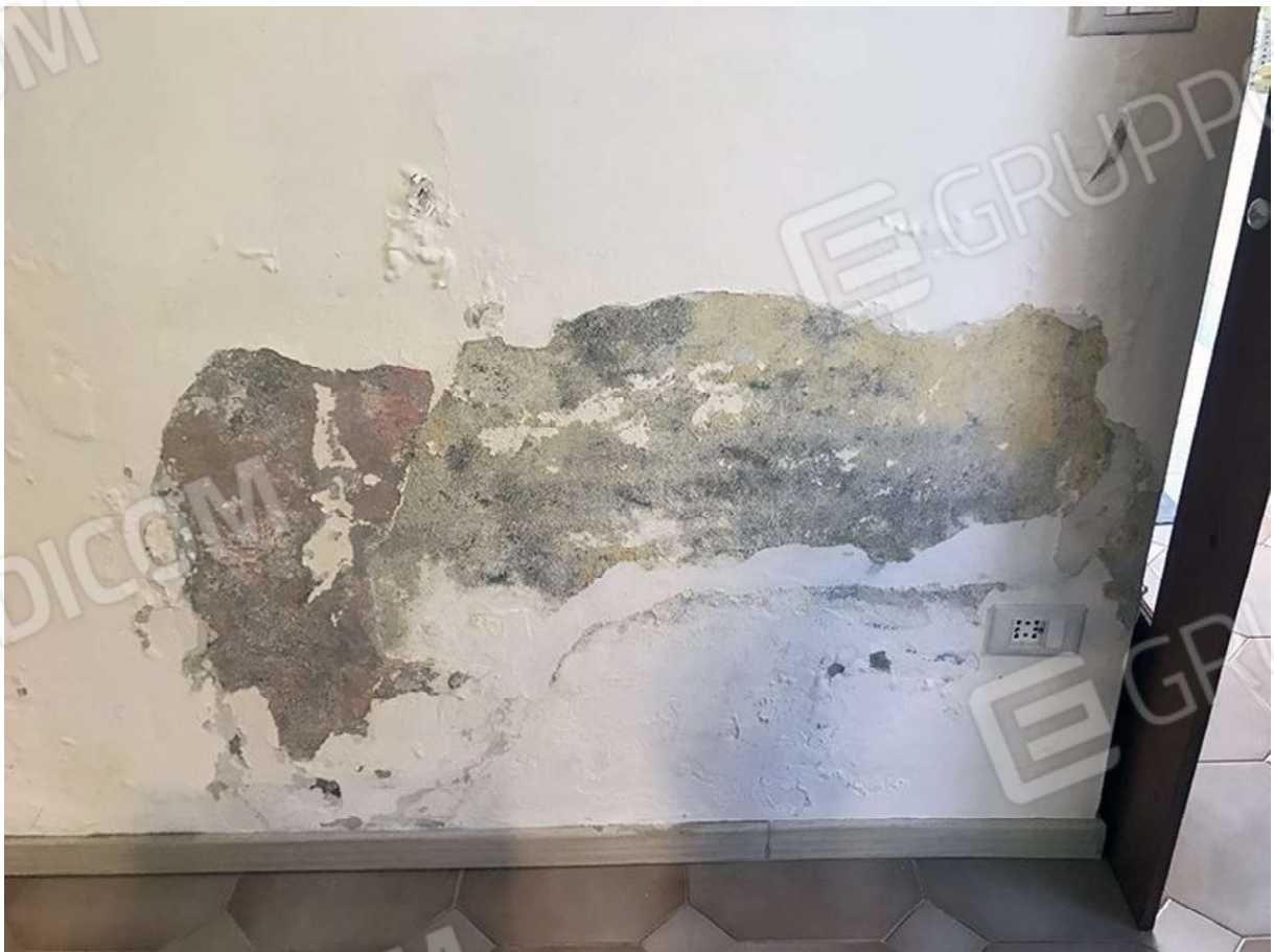
Problemi di umidità sulla parete di divisione con il cucinino.
