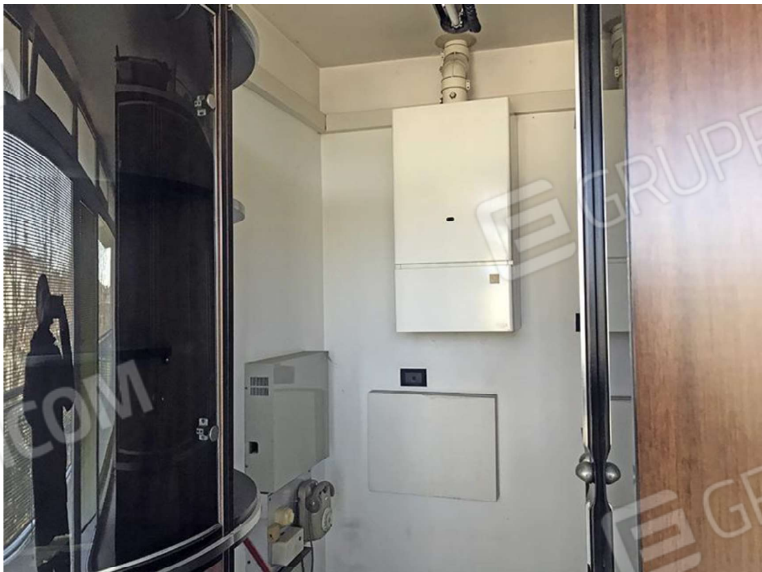
L'ufficio sub61 e la caldaia posta all'interno.
