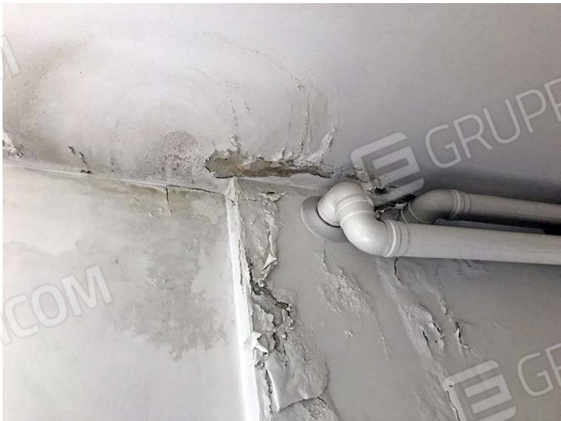
L'uscita della caldaia dell'ufficio sub60 con i problemi di infiltrazione.
