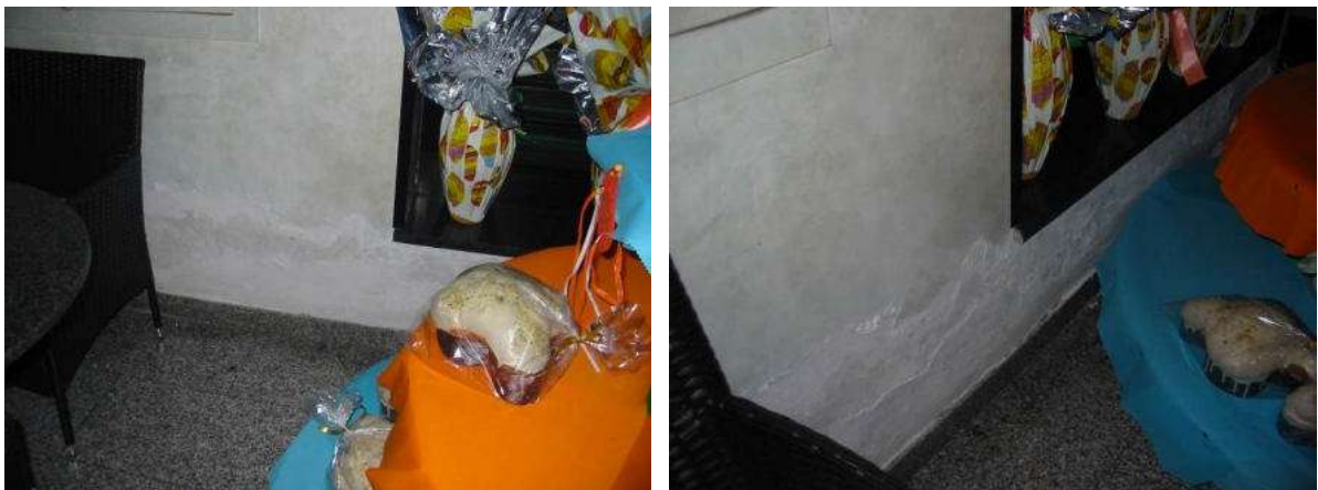
Foto 46-47 – Manifestazioni di risalita capillare lungo le pareti esterne del vano principale dell'unità.
