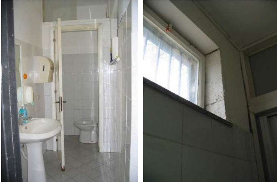
Foto 44-45 – Servizi igienici a servizio dell'attività commerciale. Particolare delle condizioni mediocri in cui versano i servizi igienici.
