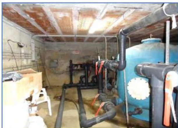
Interno locale tecnico piscina.
