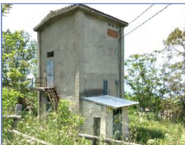
Cabina Enel nei pressi dell'immobile A1
