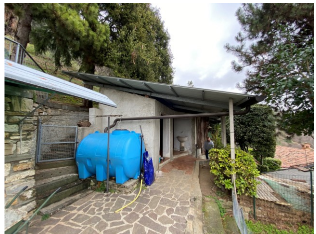
Foto30 vista su parte di realizzazioni esterne non autorizzate
