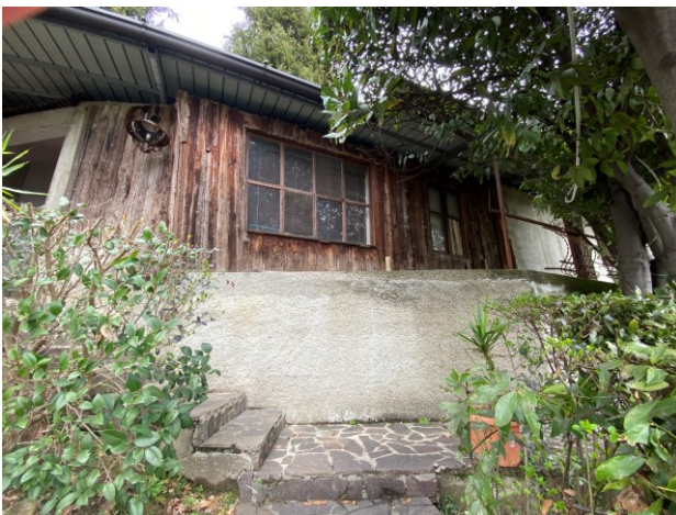
Foto29 vista su parte di realizzazioni esterne non autorizzate
