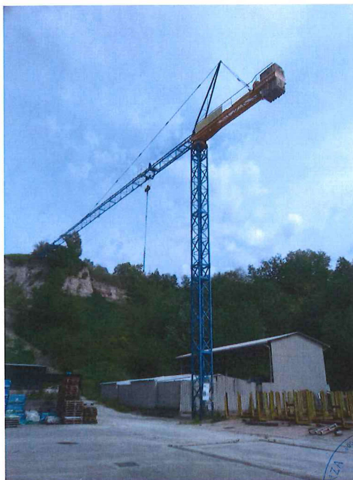
Foto 41: Castiglione Cos. – Capannone Industriale – Gru esterna;
