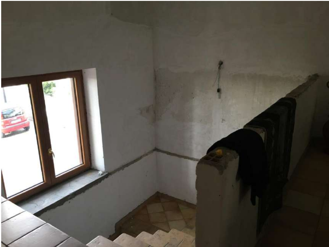
13_vano scala che conduce al seminterrato (irregolarità catastale/urbanistica)
