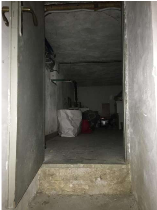
15_locale tecnico caldaia
