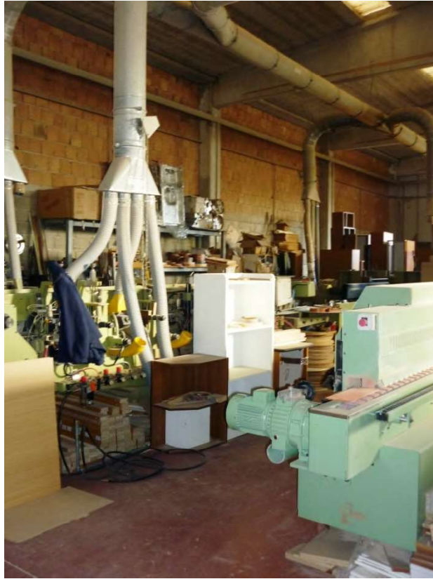
Figura 51 – Vista interna sub 17
