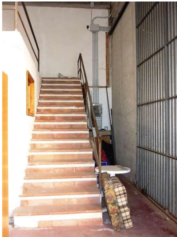
Figura 58 – Vista interna sub 18
