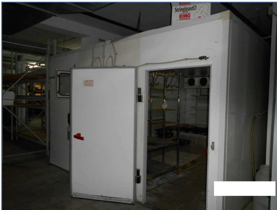
FOTO N.13 - Piano interrato: celle frigorifere.
