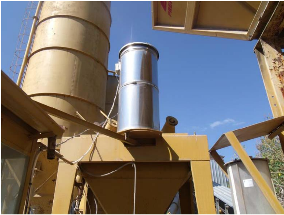
Foto n. 68: Filtro a maniche con quadro.
