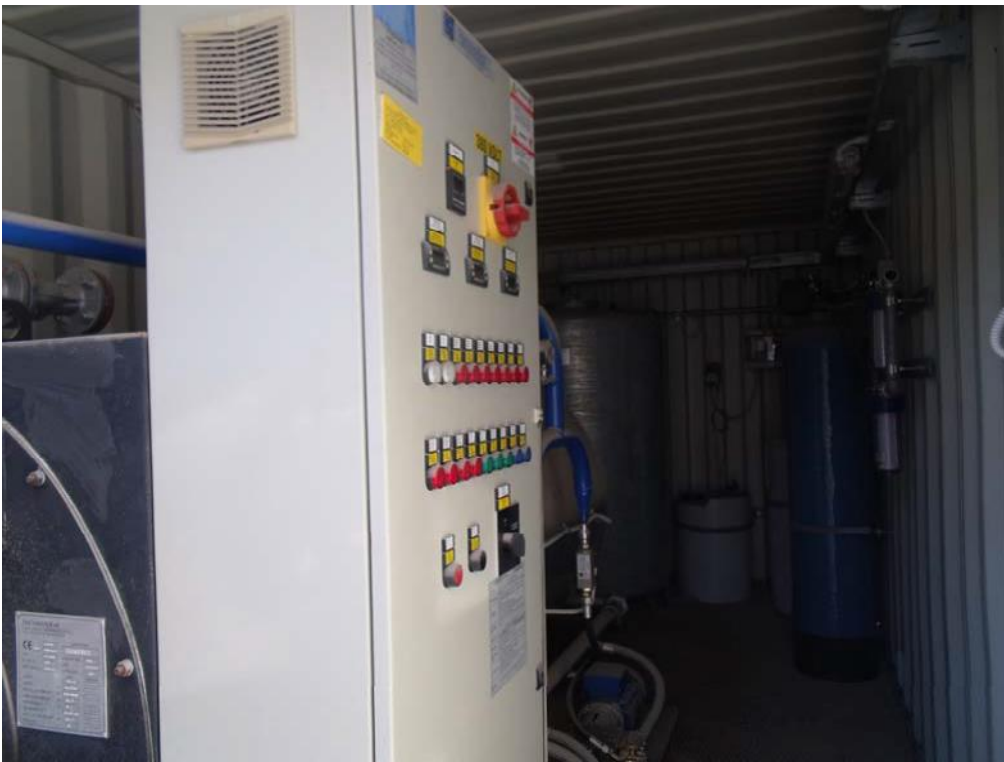
Foto n. 55: Centrale elettrica e termica per la produzione di vapore in container
