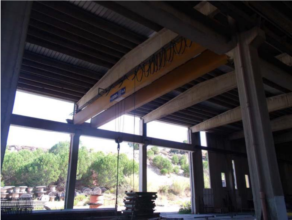
Foto n. 25: Carroponte bitrave con portata di 20 tonnellate
